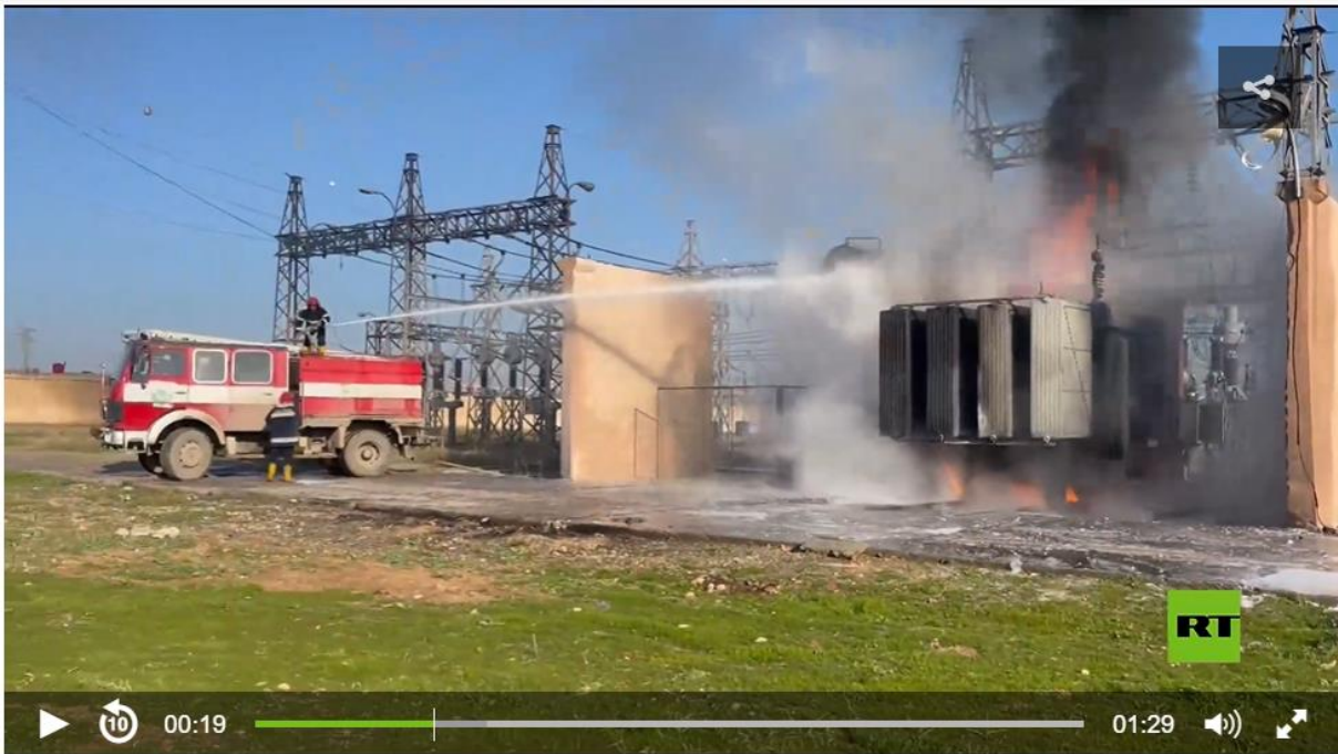
الصورة رقم (16) - لقطة شاشة من فيديو يوثق آثار القصف الجوي التركي بتاريخ 14 كانون الثاني/يناير 2024 على محطة تحويل الكهرباء شمالي القامشلي/قامشلو. المصدر: روسيا اليوم.
