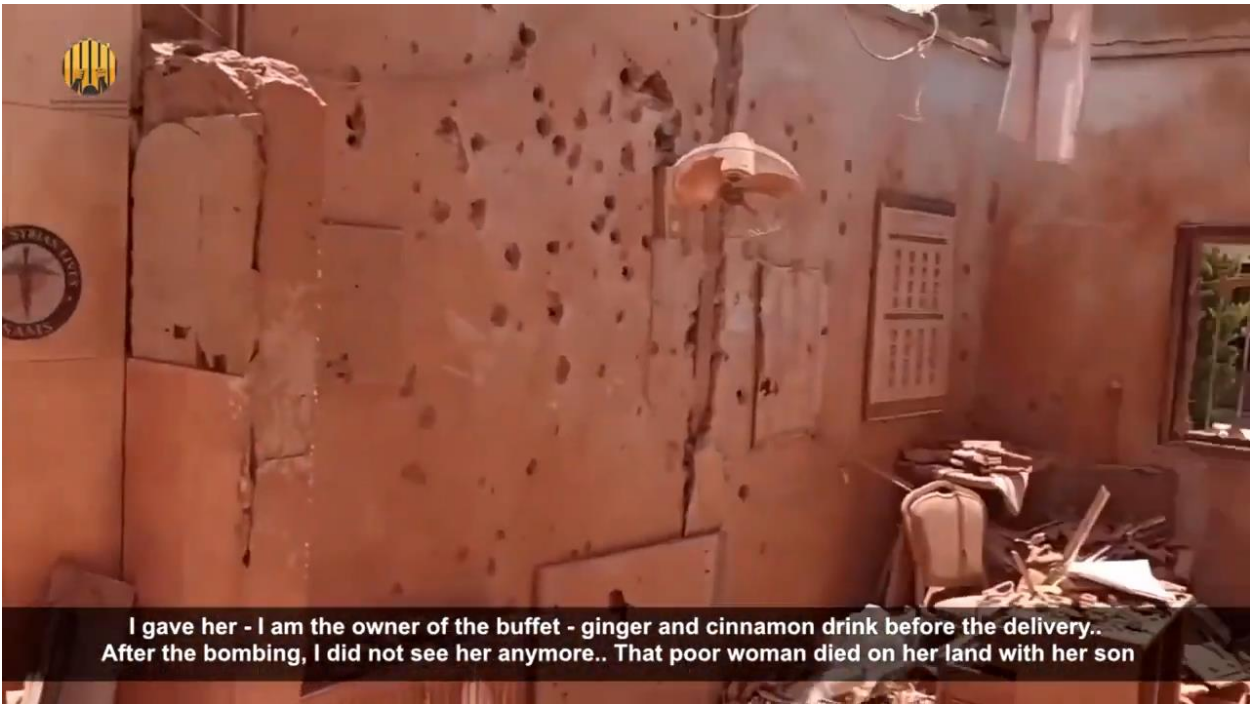
صورة رقم (33) - صورة تظهر جانب من الأضرار التي لحقت بالجزء الداخلي من المشفى: تظهر ثقوب أحدثتها الشظايا الناتجة عن الصاروخ على الجدار الذي يقع شرق وأسفل مكان الضربة.
