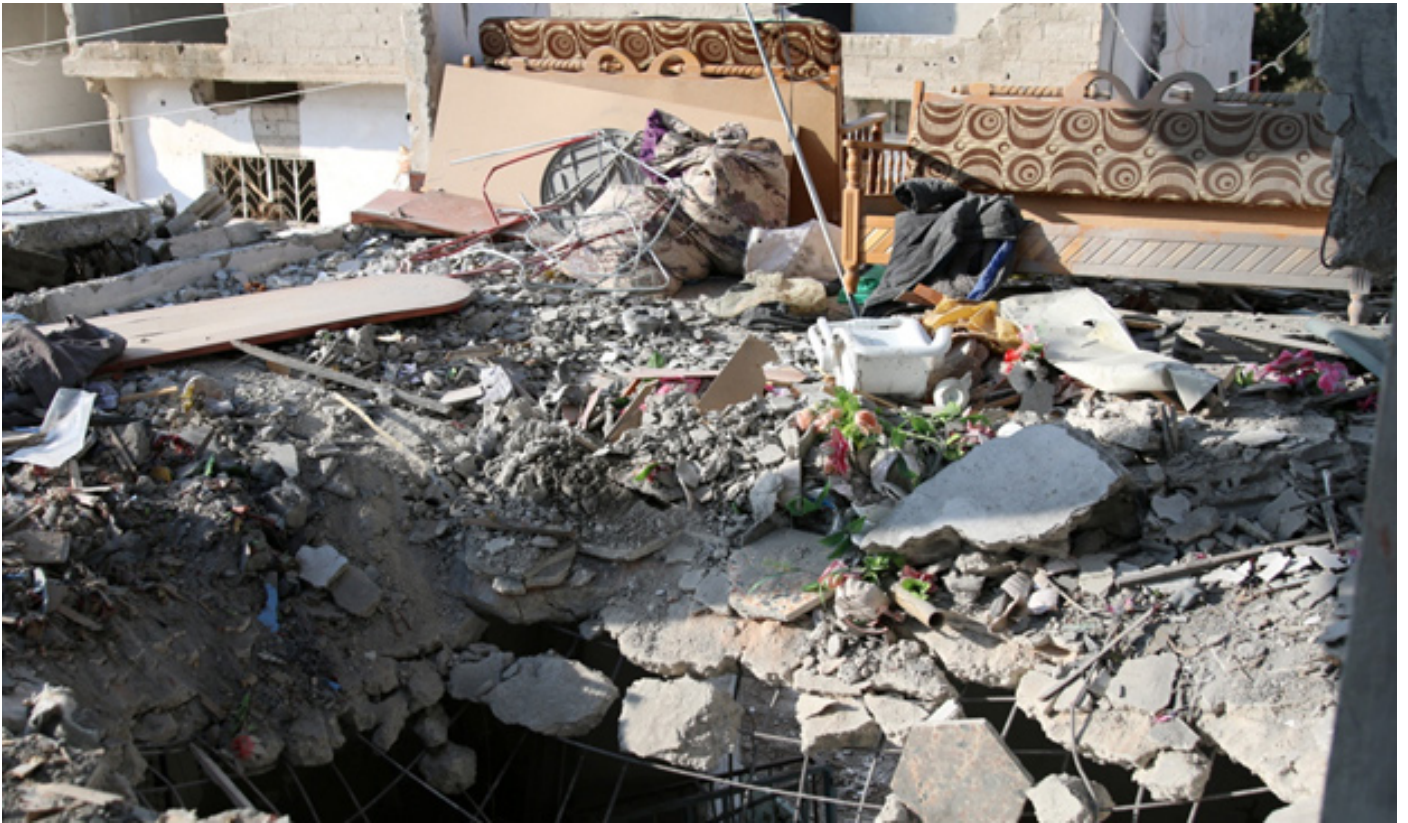
صورة تظهر الدمار الذي لحق بمنزل المدنيين نتيجة القصف العشوائي على مدينة بصرى الشام (صورة خاصة بسوريون من أجل الحقيقة والعدالة - تصوير: علاء الفقير).
