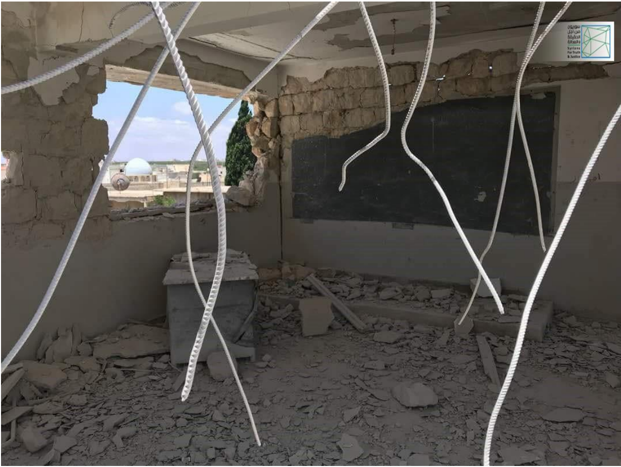
صور خاصة بسوريون من أجل الحقيقة والعدالة، تظهر حجم الدمار الذي لحق بالمدارس في بلدة بنش في ريف إدلب، إثر تعرضها لقصف جوي بتاريخ 11 حزيران/يونيو 2018.
